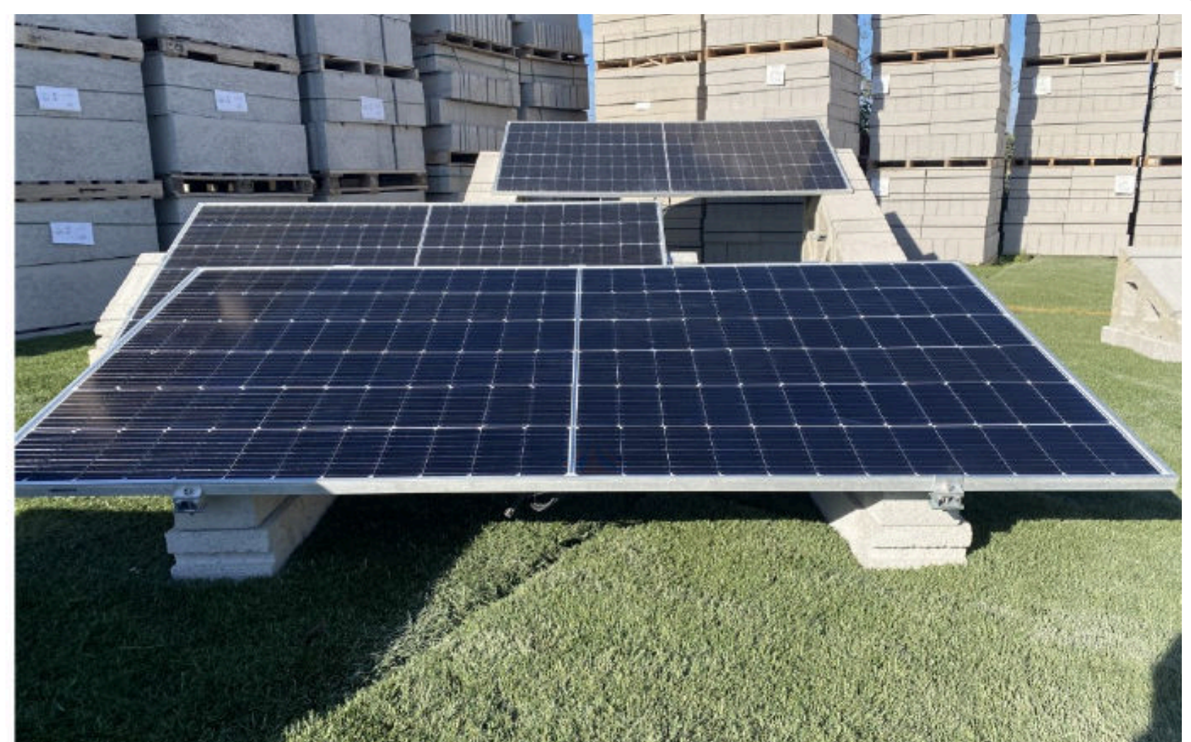
Vista general de fila con extensor
